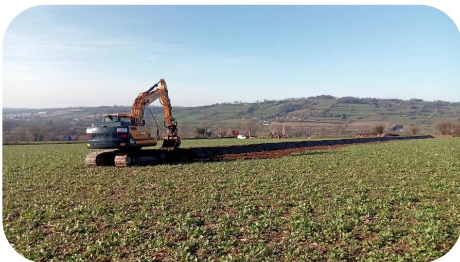
Terrassement d'un talus sur le versant de la Gièze en face le Mont Robin, commune du Chefresne, Percy en Normandie. (SIAES, Mars 2023)
